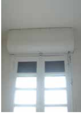
Volet roulant et fenêtre avant rénovation
